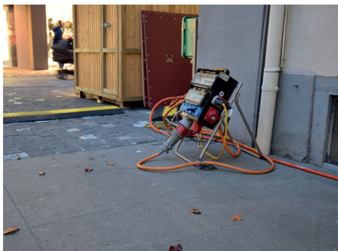
Mobiler Stromverteiler im Einsatz bei Märkten
