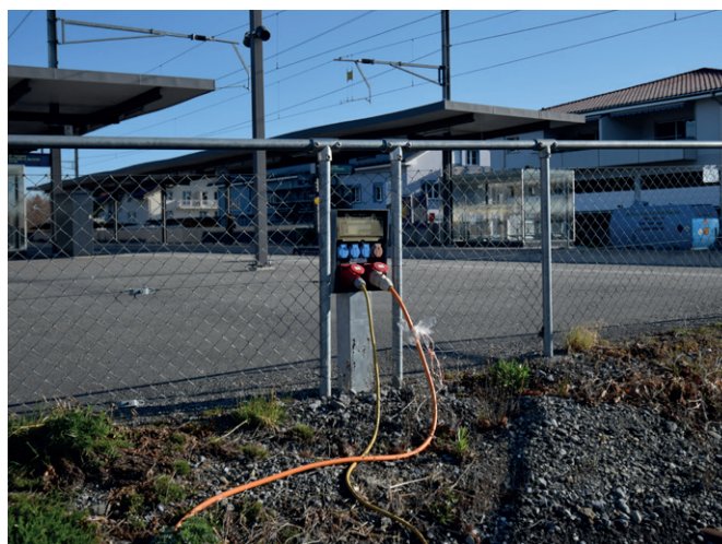
Stromverteiler am Bahnhof Oberriet
