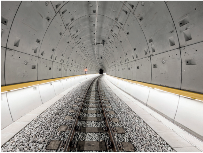
LaneLED GFK, Tunnel Glatscheras
