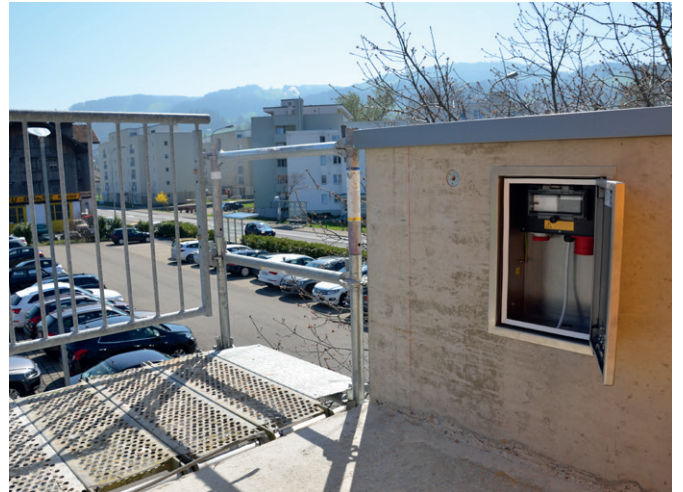
Unauffällig verbauter Unterputz-Verteiler
