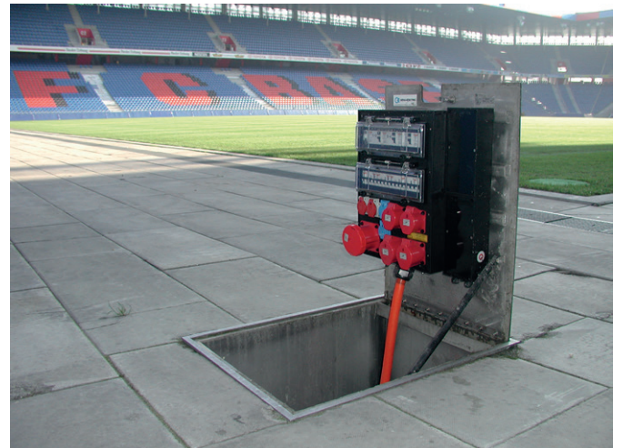
Unterflurelektrant, St.Jakob-Park Basel
