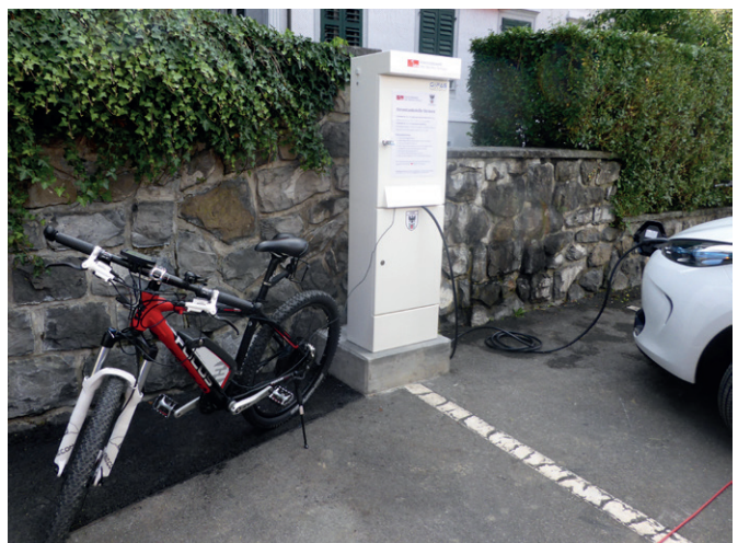
Ladesäule für E-Autos EBS Schwyz
